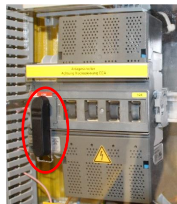
Abbildung 4: Berührungsschutz demontierbar bei eingeschaltetem Hauptschalter
