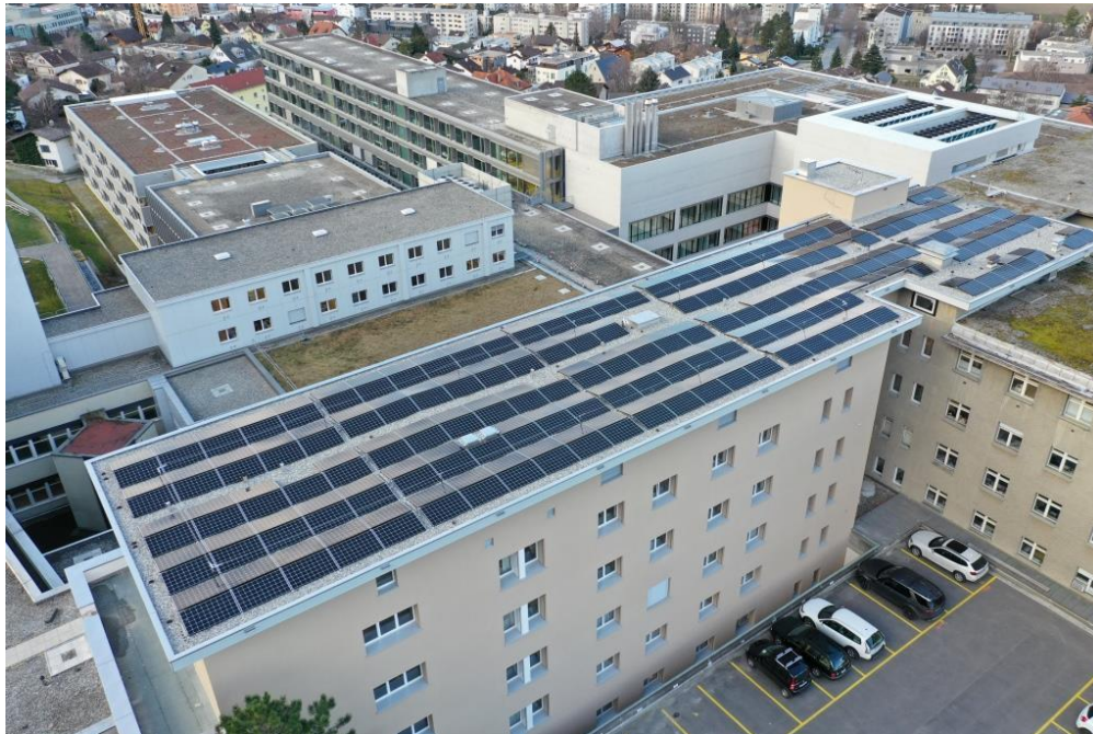
Abbildung 25: aufgefächerte PV-Anlage Haus A Block IV
