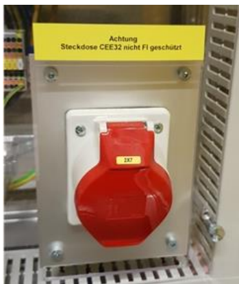
Abbildung 31: CEE32 Steckdose in Schaltschrank
