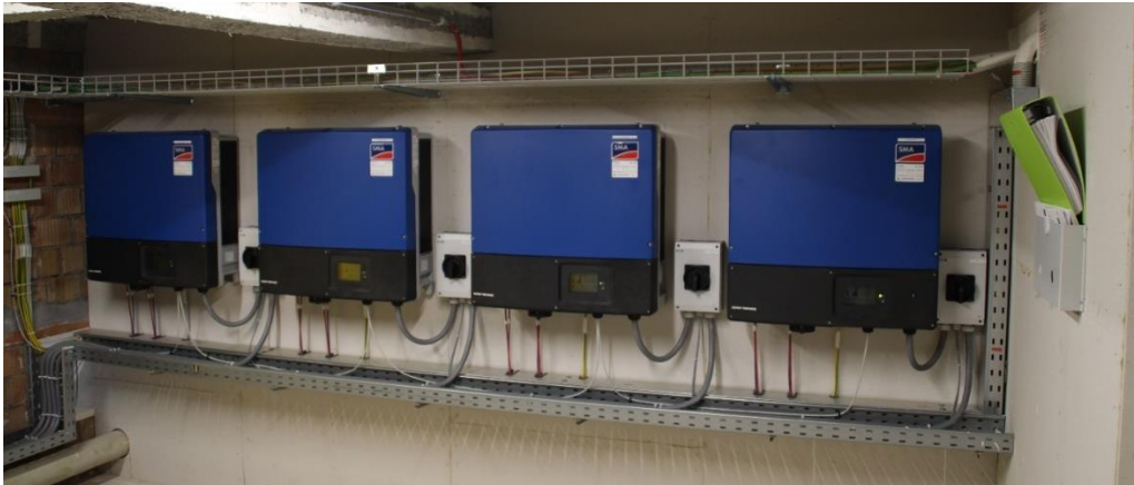
Abbildung 23: Wechselrichter mit ortsgrennter Kabelführung DC/AC
