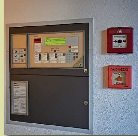
Die hausinternen Brandmelder unterstützen die Sicherheit in allen Gebäuden.
