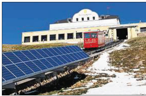
Solarstrom wird verkauft, aber auf Muottas Muragl verbraucht: Fotovoltaik-Anlage entlang des Bahntrassees. (Foto Rolf Canali)
