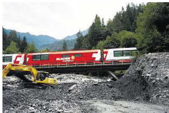
Weg mit dem Geschiebe: Die RhB muss bei ihrer Brücke am Ausgang des Carreratobels regelmässig die Bagger auffahren lassen.
